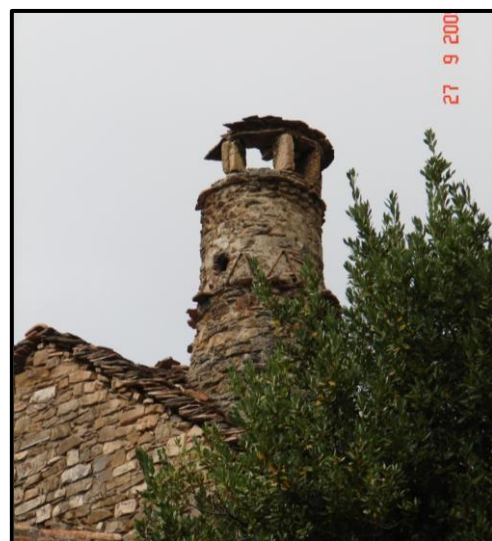
Chimenea cilíndrica en peligro de desaparecer
