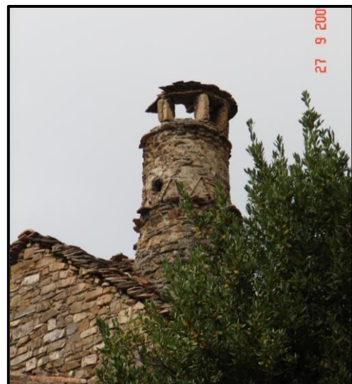
Chimenea cilíndrica en peligro de desaparecer
